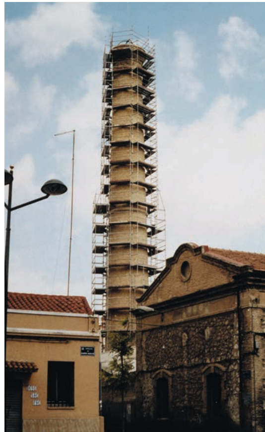
Chimenea industrial de la avenida Gaspar Aguilar, en restauración. Valencia. 2003. Revista Noticias CAAT. Febrero 2004. Archivo CAATIE Valencia.
