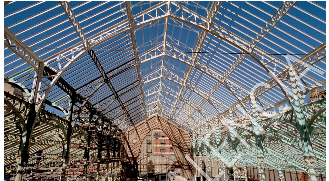
El Mercado de Colón restaurando su estructura. Valencia. 2002. Fotografía: Miguel Ángel Ortells. Colección particular de Ana Valdés.
